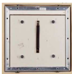
Eingebaut ohne Frontplatte
